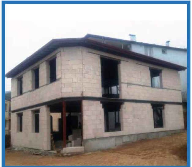
Ruhsatsız Kaçak Yapı
