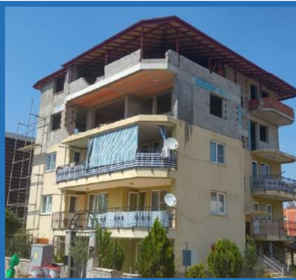
Kaçak Çatı Katı
