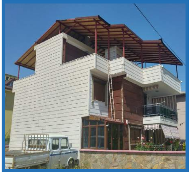
Kaçak Çatı Katı ve İlave Yapılar
