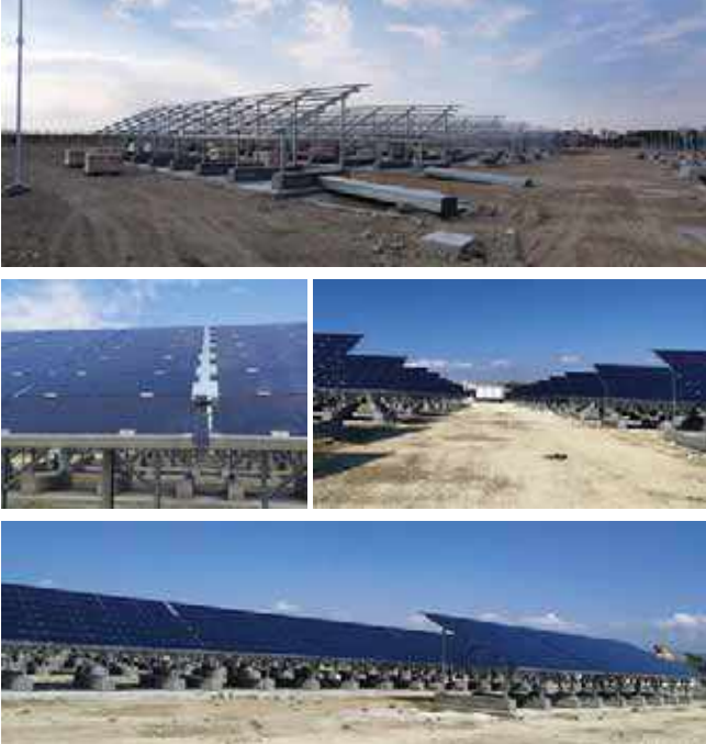
Şekil 78. Evliya Çelebi Güneş Enerji Santrali Projesi
