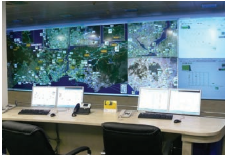
Scada Sistemi Yeni Kontrol Merkezi
