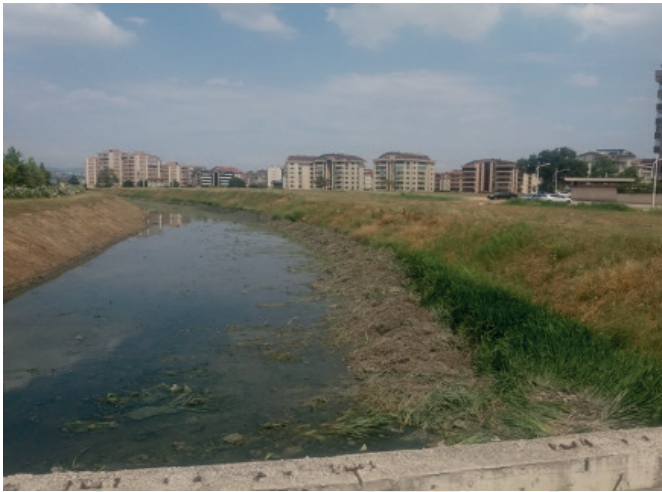
Nilüfer Özlüce Ayvalı Dere Temizlenmeden Öncesi
