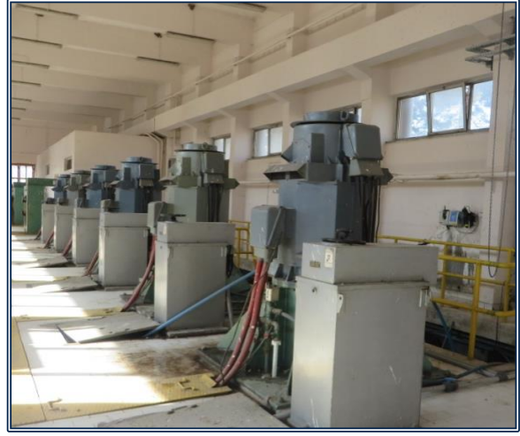
Hamsu Pompa İstasyonu
