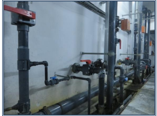
Alüminyum Sülfat Pompa ve Hattı
