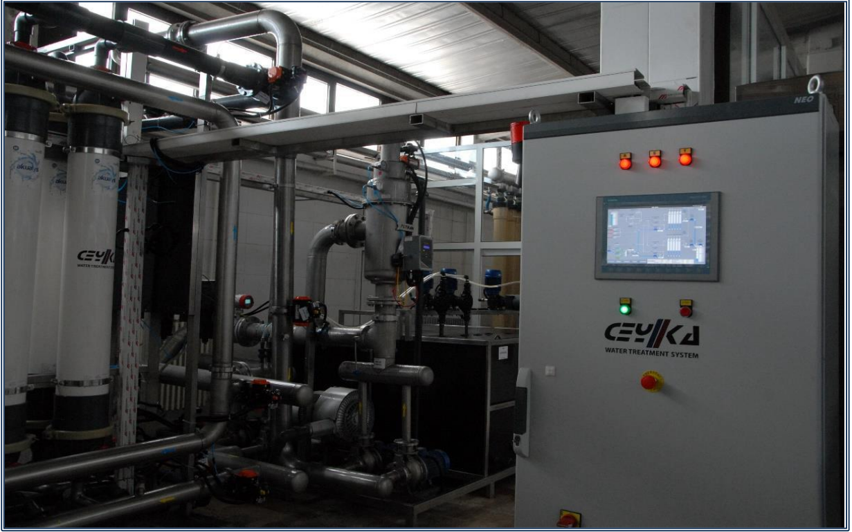
Filtre SCADA Panosu
