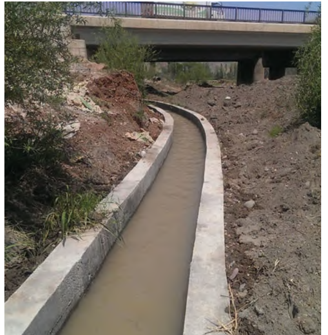
Oltu Tuzla Yolboyu Mahallesi Sulama Tesisi
