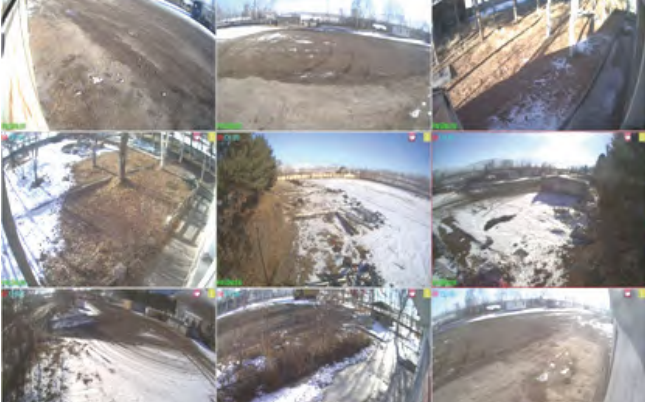
Pasinler İlçe Şantiyesine 14 IP kamera kurulumu yapılarak merkezimizden izlenebilmektedir.
