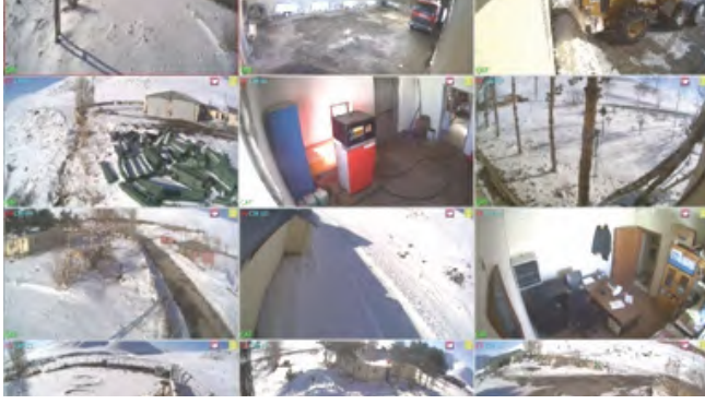
Çat İlçe Şantiyesine 15 IP kamera kurulumu yapılarak merkezimizden izlenebilmektedir.
