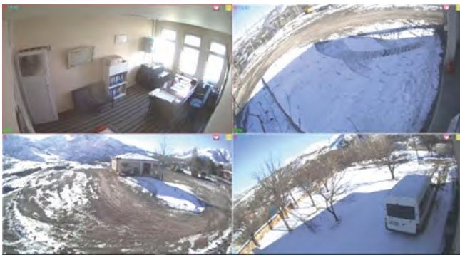
İspir İlçe Şantiyesi 10 IP kamera kurulumu yapılarak merkezimizden izlenebilmektedir.
