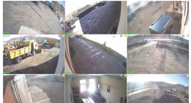
Narman İlçe Şantiyesine 10 IP kamera kurulumu yapılarak merkezimizden izlenebilmektedir.
