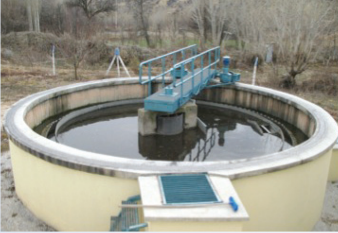
Resim 14. Başarakavak Atıksu Arıtma Tesisi Son Çökeltme Havuzu
