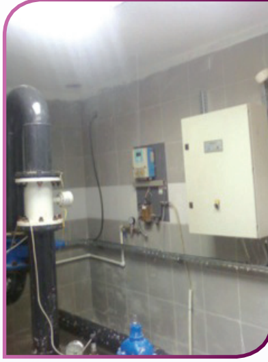
SCADA kumanda panosu
