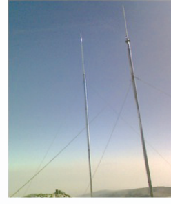
Ağlayan Çal Dağı SCADA Anteni
