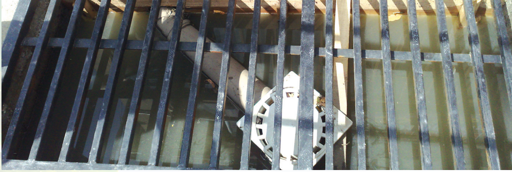
Yün-Halı Yıkama İşletmeleri Ön Arıtma Tesisi
