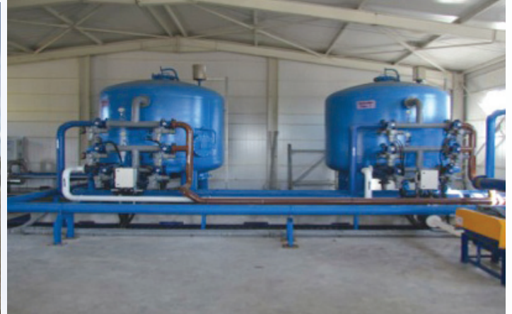
Resim 4. Geri kazanım tesisi multimedya filtre ünitesi
