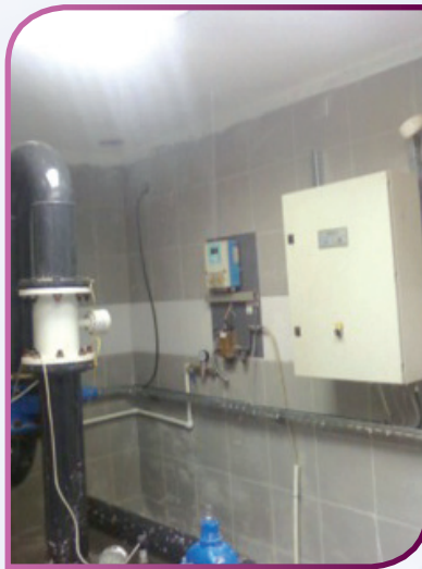
SCADA kumanda panosu
