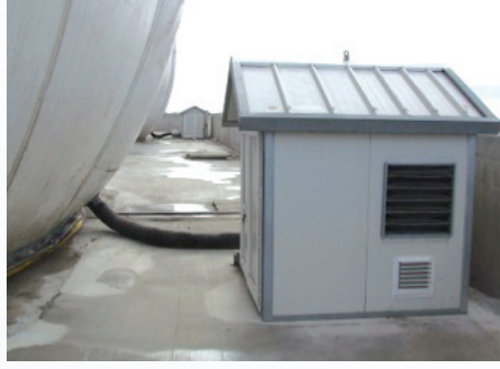
Resim 12. Gaz balonları etrafına yapılan beton saha ve blower motorlarını korumak için yapılan kabinler
