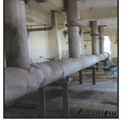
Resim 13. Yeni süzünü suyu boru hattı
