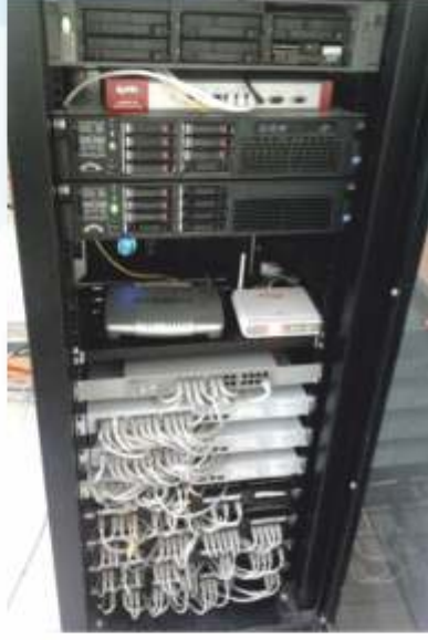
Server Kabinini Ön Panel Açık
