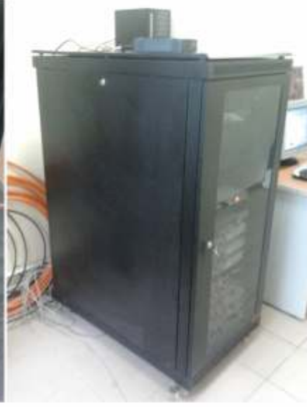
Server Kabin Son Durumu
