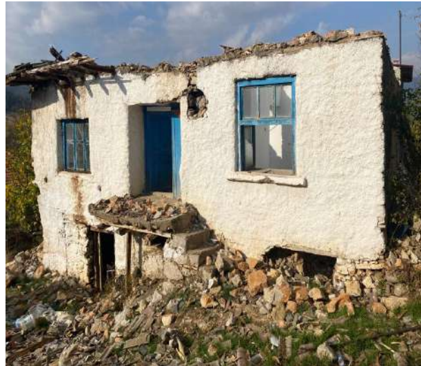
Resim 8 Metruk Yapı Örneği
