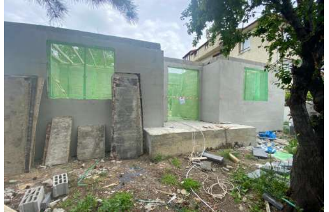
Resim 2 Tespit Edilen Kaçak Yapı Örneği
