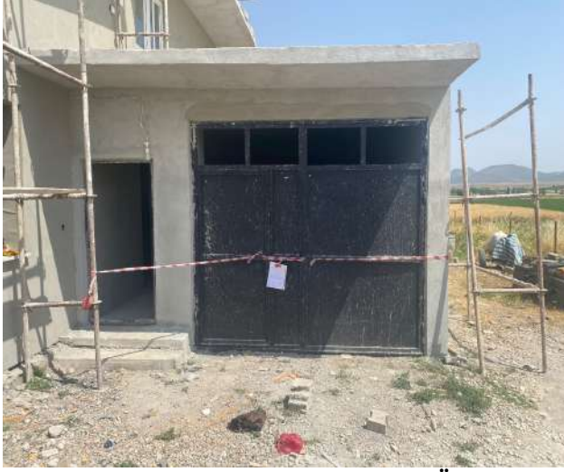
Resim 3 Tespit Edilen Kaçak Yapı Örneği
