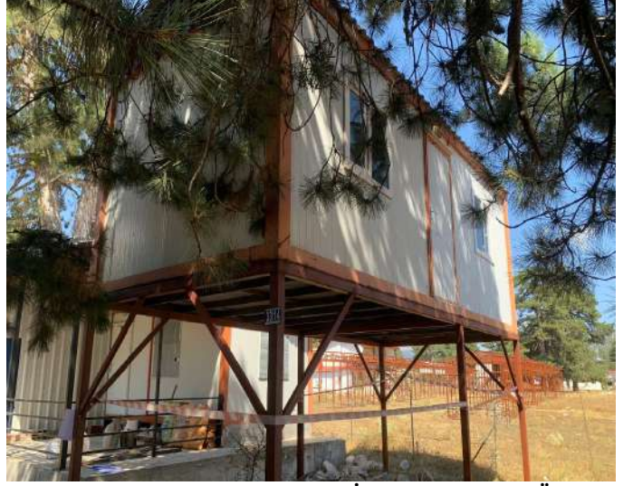
Resim 6 Yapı Kayıt Belgesi İptal Edilen Bina Örneği
