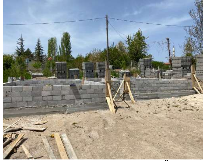
Resim 4 Tespit Edilen Kaçak Yapı Örneği
