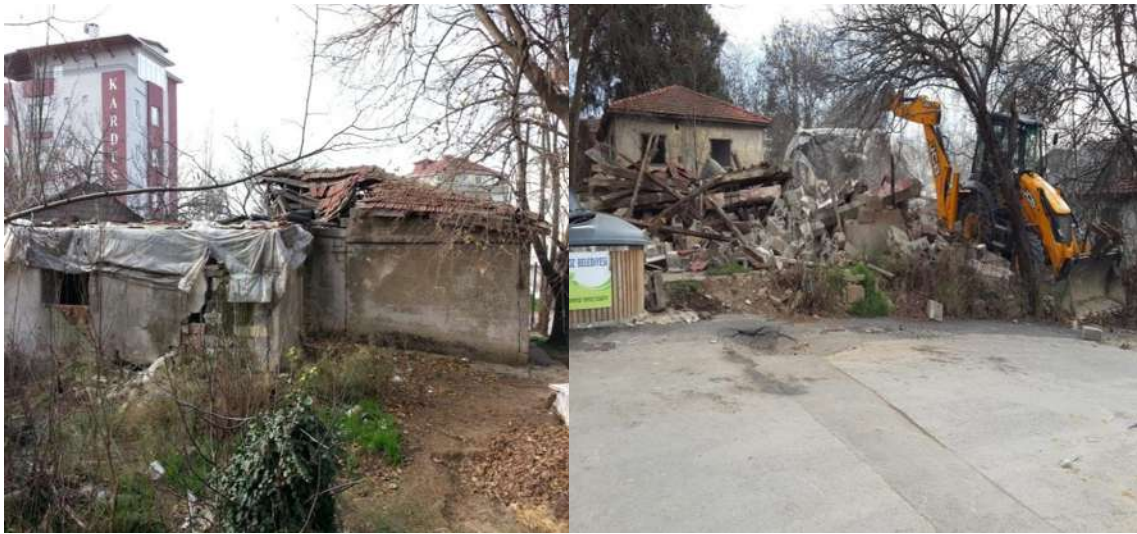
Kavacık Mahallesinde 3194 sayılı yasanın 39. maddesine göre yapılan yıkıma ait fotoğraf
