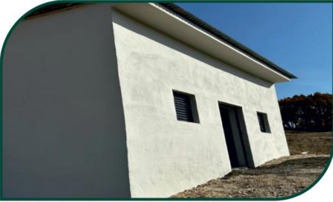
Mazgirt-İsmaili Köyü-GörcanMz.İçmeSuyu Deposu İşi
