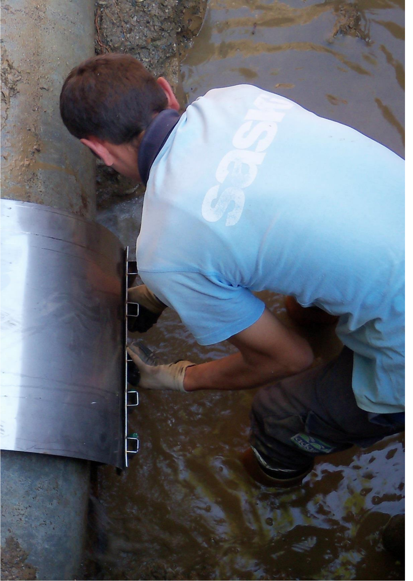
Kanal Arızası Müdahalesi
