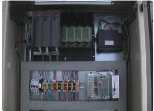
Depo RTU Panosu
