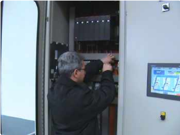
Pompa istasyonu RTU Panosu
