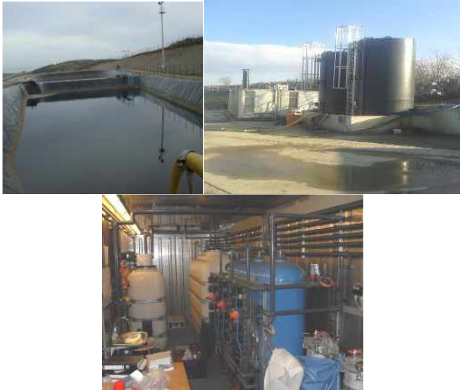
Resim : Sızıntı Suyu Arıtma Tesisi
