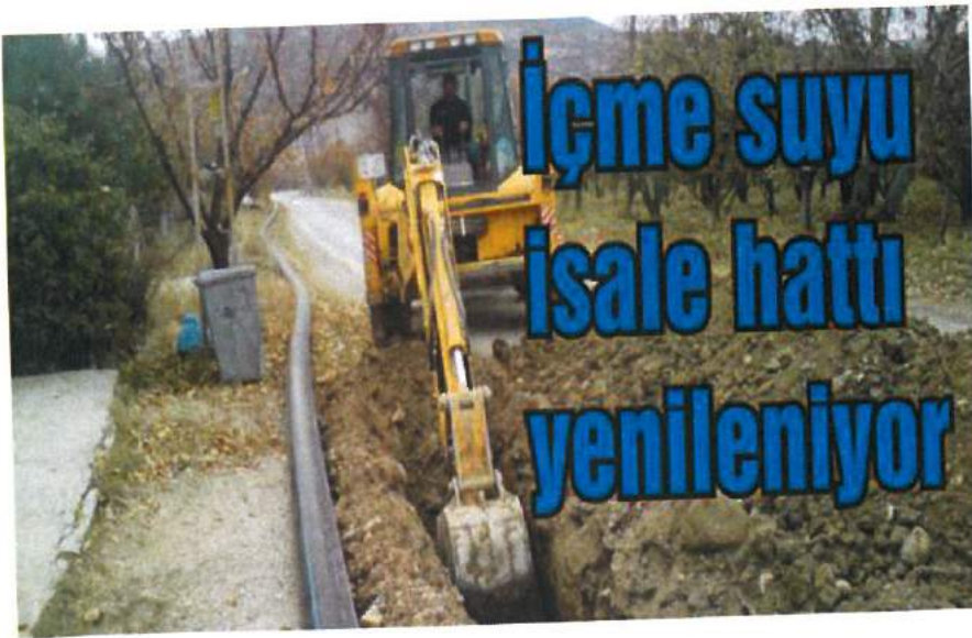
İçme suyu isale hattı
