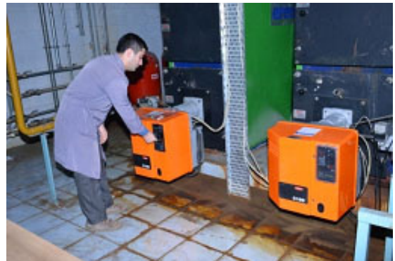
Doğalgaz kazanı çalıştırma ve kontrol
