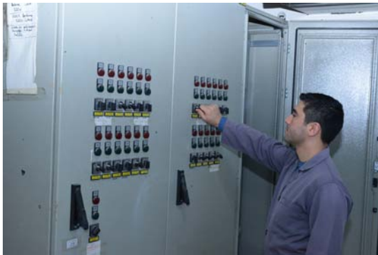
İklimlendirme kontrol panoları çalıştırma
