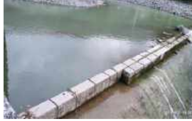
İçme Suyunun Kaynağı Olan Uğur Suyu Regülatörü.
