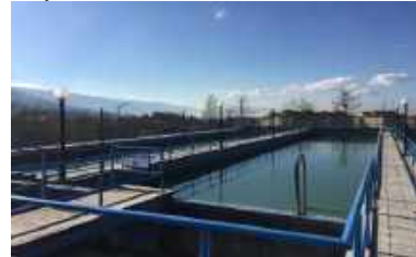
İçme Suyu Arıtma Tesisi Durultucu Havuzlar
