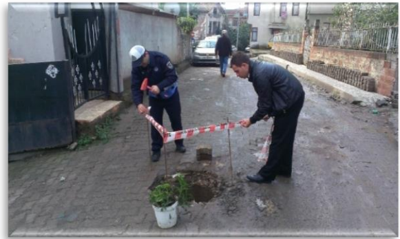
Kırılan Kanalizasyon Bacası Kapağı Güvenlik Önlemi Alınması
