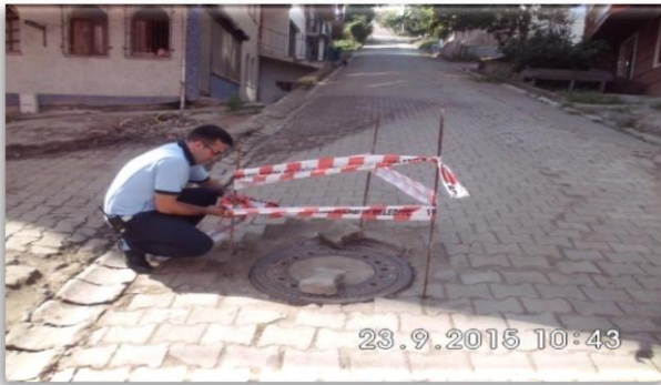
Kırılan Kanalizasyon Bacası Kapağı Güvenlik Önlemi Alınması
