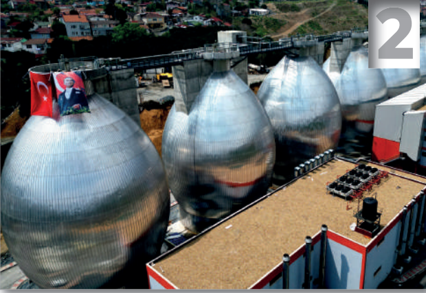
Baltalımanı Biyolojik Atık Su Arıtma Tesisi
