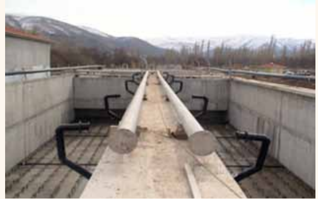
Şekil 28. Atık Su Arıtma Tesisi
