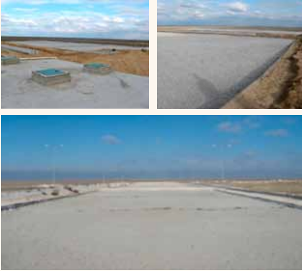
Şekil 49. Tuz Gölü ÖÇK Bölgesinde Doğal Arıtma Çalışmaları
