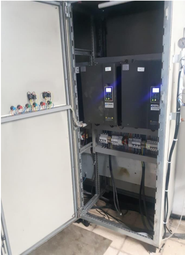
Hidrofor Sürücü Arızalarının Giderilmesi
