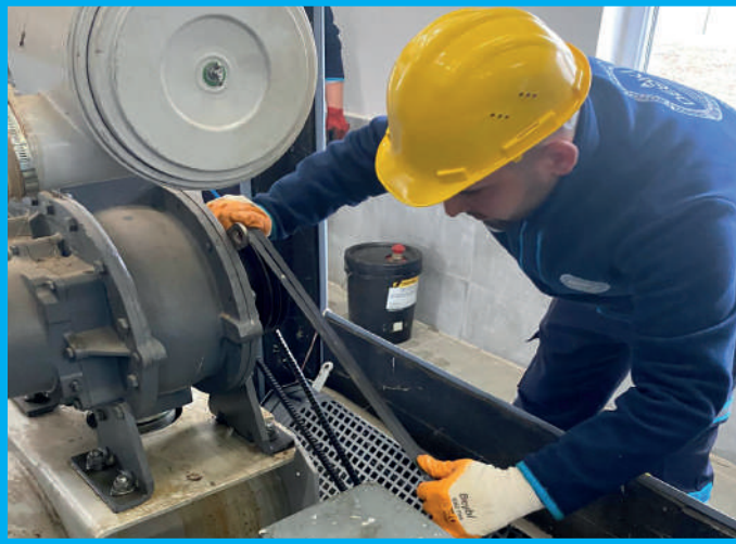
Havalandırma Blower Kayış Kasnak Sistemi Kontrolü
