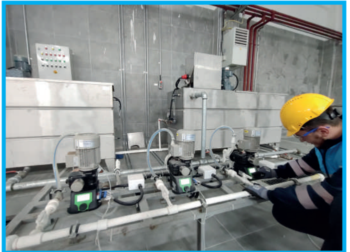
Polielektrolit Dozlama Pompalarının Bakımı
