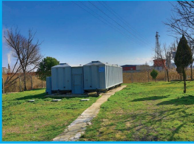
Köprübaşı- Sazak Paket Atıksu Arıtma Tesisleri
