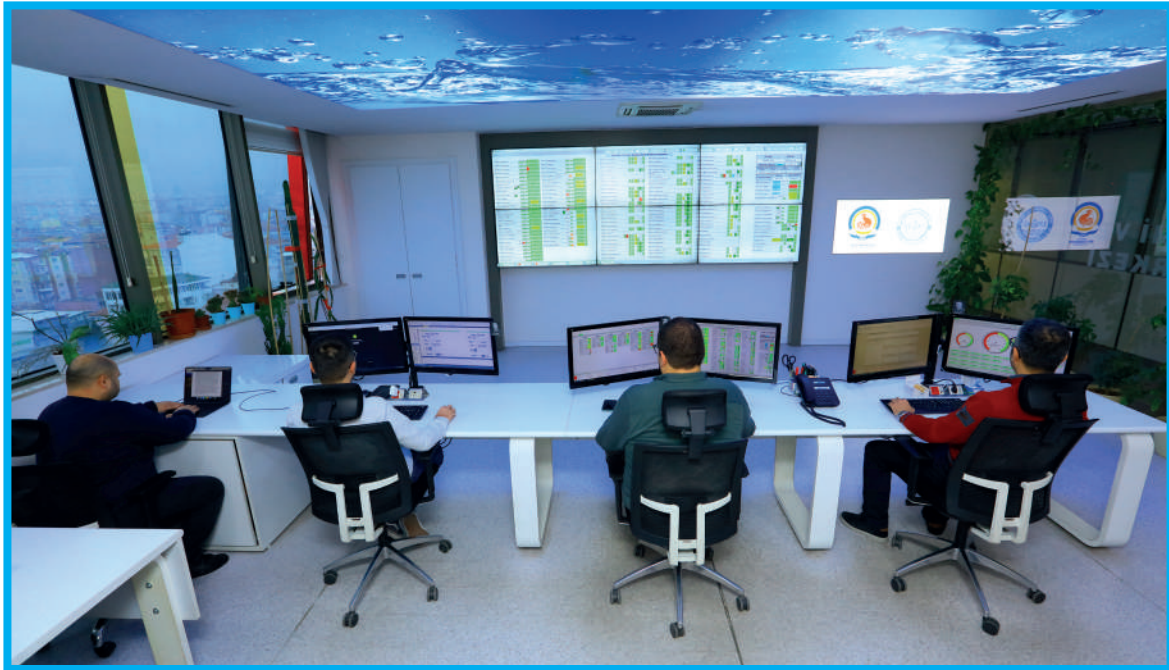
İçme Suyu SCADA Merkezi
