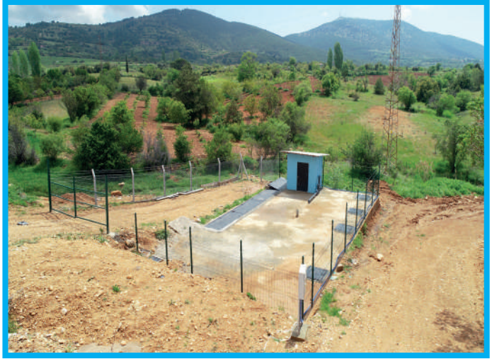
Güzelpınar Paket Atıksu Arıtma Tesisleri
