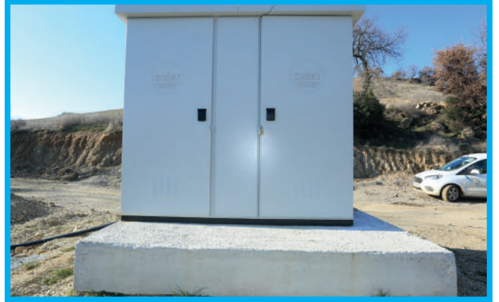
Buldan İlçesi Karaköy Mahallesi Pompa İstasyonu
