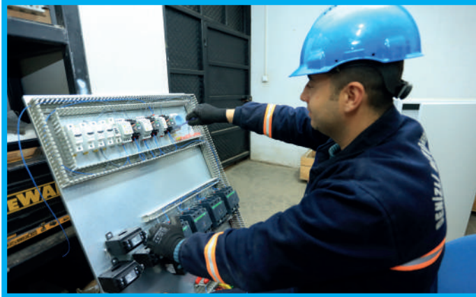
İçme Suyu Pompa Kontrol Panosu İmalatı
