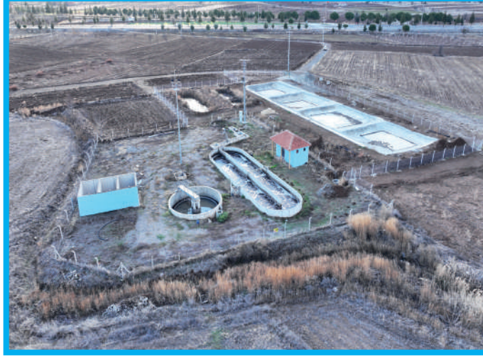
Dedebağ Atıksu Arıtma Tesisi Genel Görünüm
