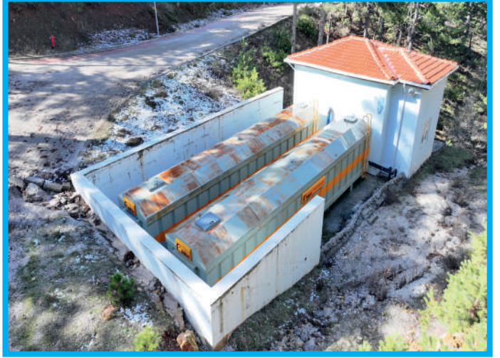
Zeytinyayla Paket Atıksu Arıtma Tesisleri
