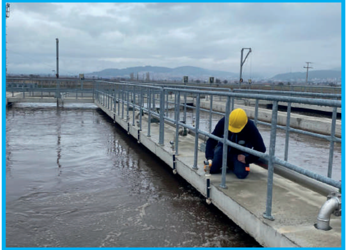
Havalandırma Havuzu Difüzör Sistemi Hava Kaçağı Kontrolü
