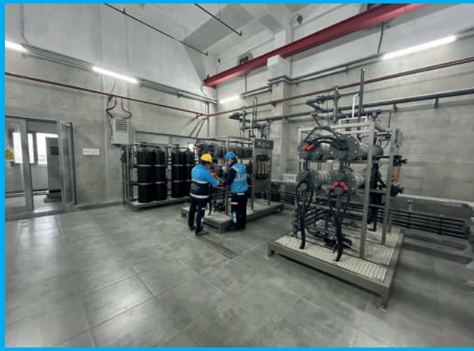
Klor Jeneratörü Elektroliz Ünitesinin Bakımı
