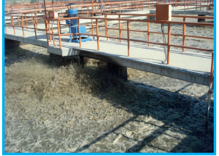
Denizli Merkez Atıksu Arıtma Tesisi Havalandırma Havuzu
