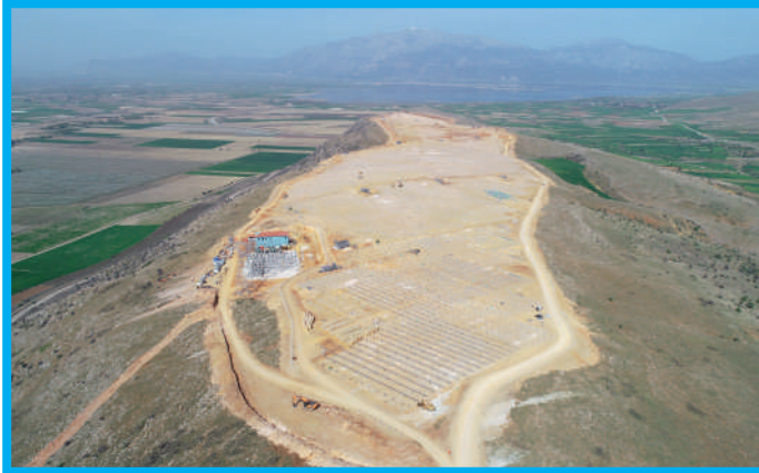
Çivril, Tokça Güneş Enerji Santrali (01.04.2024 Öncesi)
