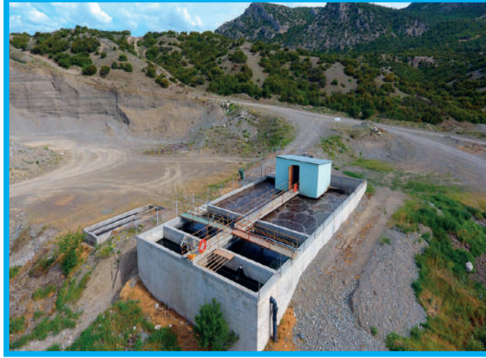
İnceler Atıksu Arıtma Tesisi Genel Görünüm
