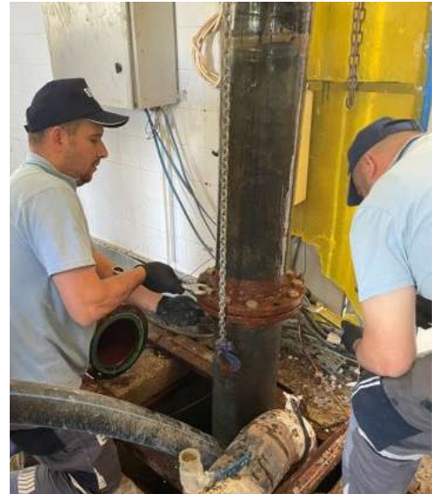
Çifteler Paket Arıtma Tesis
