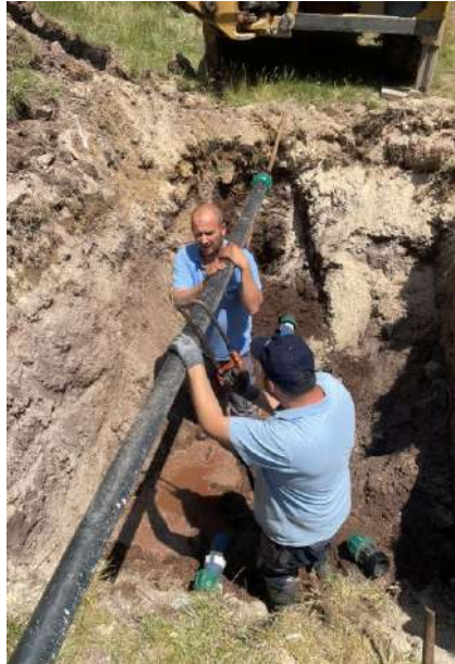
185 Binası Temizsu Hattı
