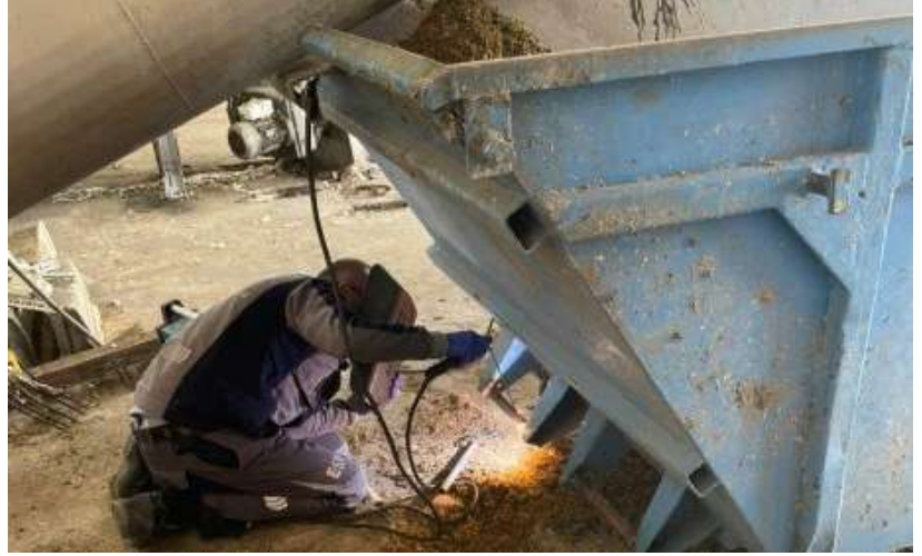
Atıksu Arıtma Tesis
