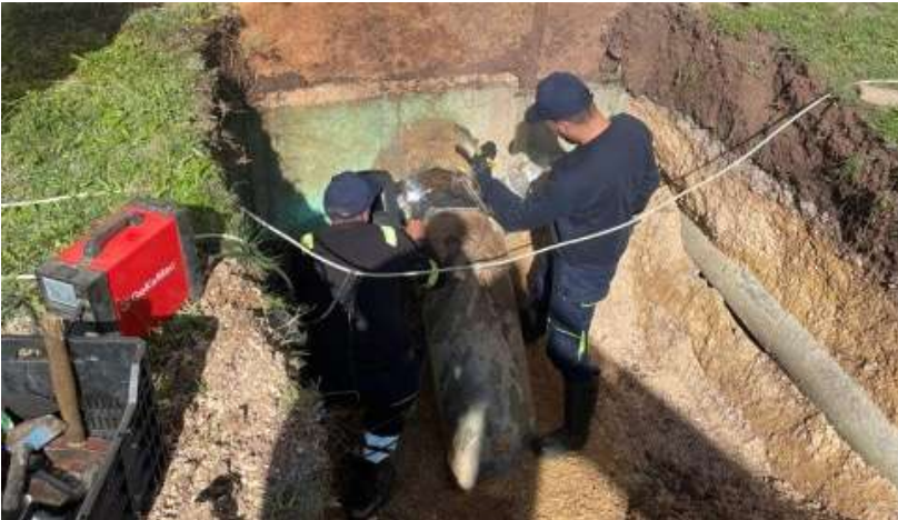
Sazova Atıksu Terfi Merkezi
