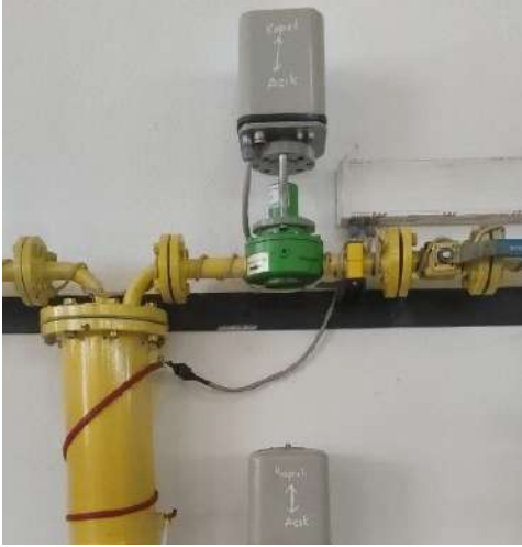
Klorlama Ünitesi Ekipmanları
