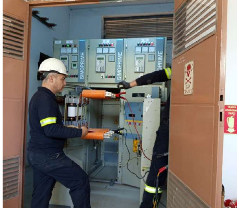
Arıtma Tesis OG Modülleri
