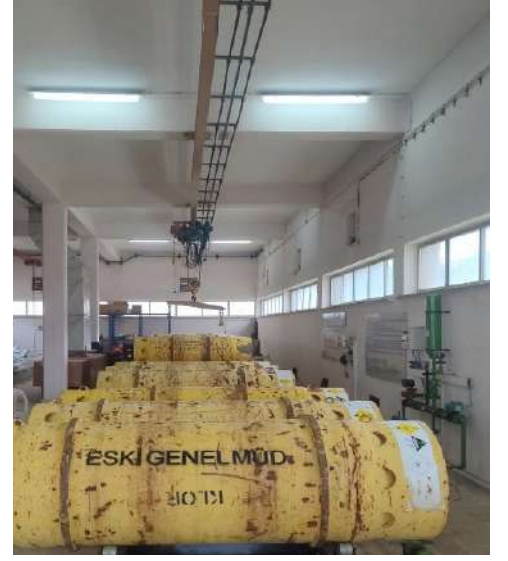
Gaz Klor Tankları
