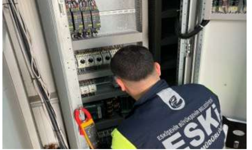
Çifteler Paket Arıtma Tesis
