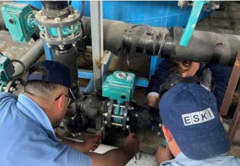
Kırka – Bozan Paket Arıtma Tesis
