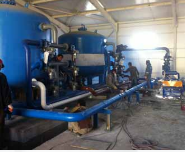
ARITILMIŞ ATIKSU GERİ KAZANIM TESİSİ VE MÖR ŞEBEKE UYGULAMASI İŞİ
