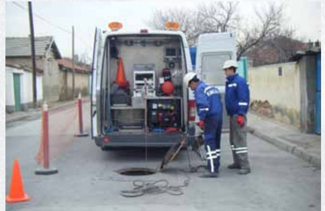
KANAL GÖRÜNTÜLEME ARACI İLE ARIZA TESBİT ÇALIŞMALARI
