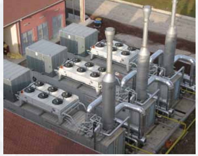
BİYOGAZDAN ELEKTRİK ENERJİSİNE DÖNÜŞÜM ÜNİTESİ
